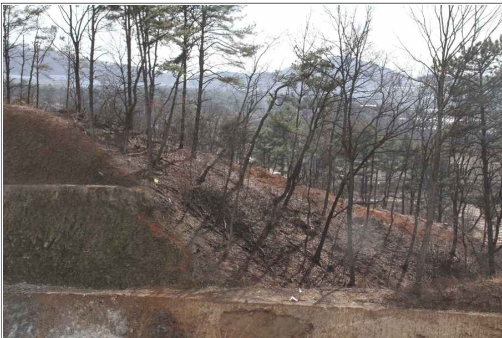
【그림 6】 상부 자연비탈면 (수목의 기울어짐 및 포행)
