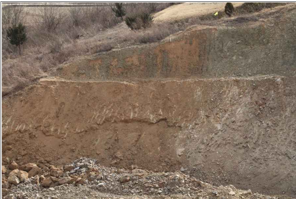
【그림 10】 토사유실 및 우류침식, 지하수 유출 (2)
