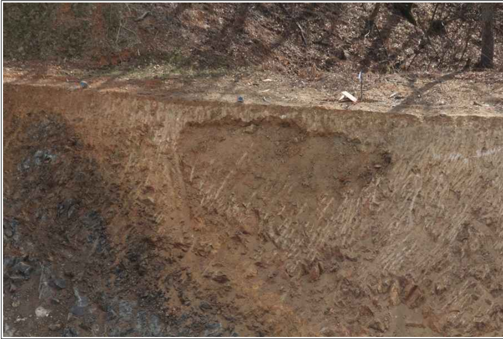
【그림 9】 토사유실 및 우류침식, 지하수 유출 (1)
