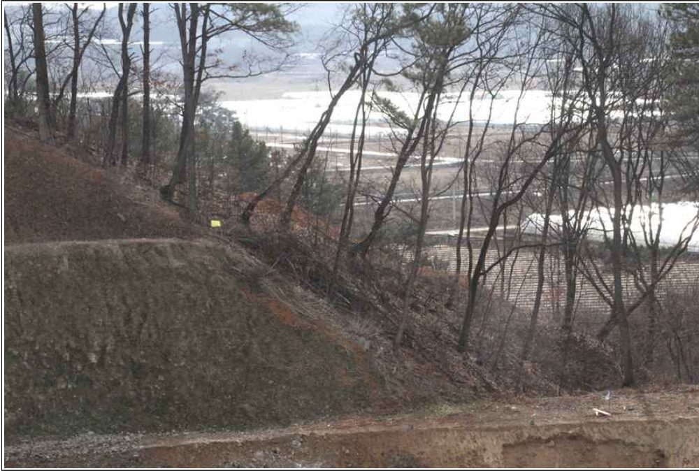
【그림 5】 상부 자연비탈면 (수목의 기울어짐 및 포행)
